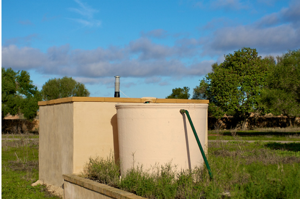
Die neue Kläranlage auf der Finca S'Atalaia.
