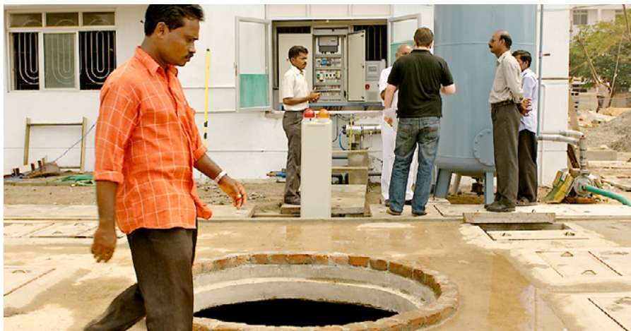
Die indischen Abwasserspezialisten der SRM-Universität und des ATB-Partners Mother Indus Aqua Solutions vor der Steuerung der AQUAMAX®-Anlage.
